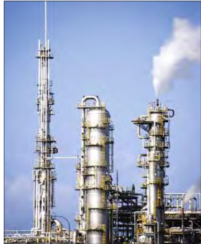
Kolonnen in einer Raffinerie
